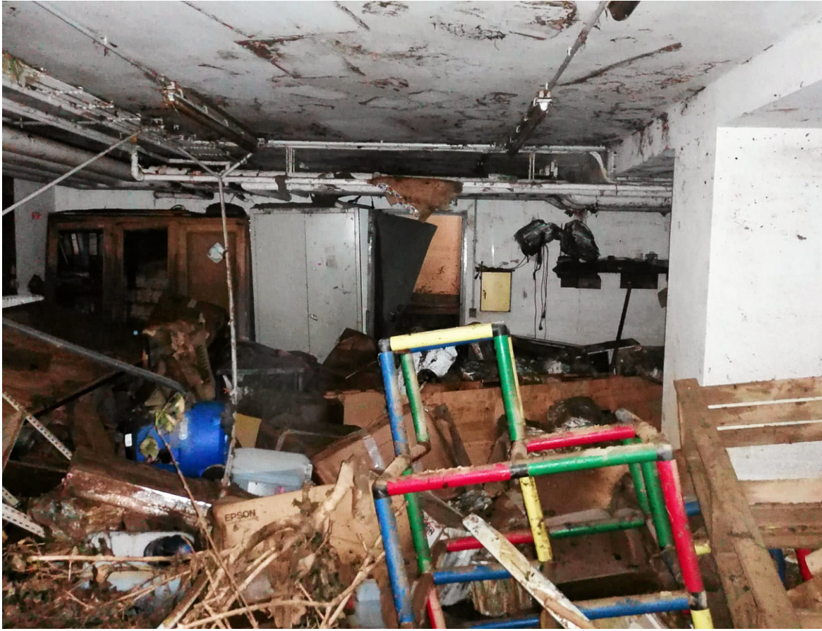
So sah es an der Grundschule in Bad Neuenahr nach der Flutkatastrophe aus.
